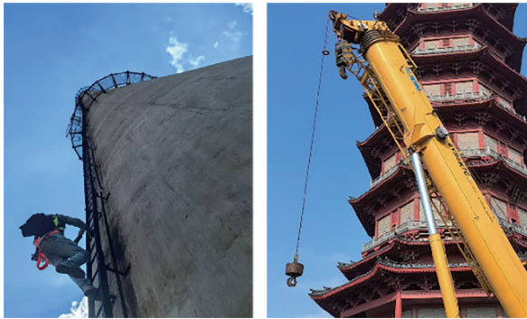
图 5 高光强 A 型障碍灯安装图(图片来源:自摄)
